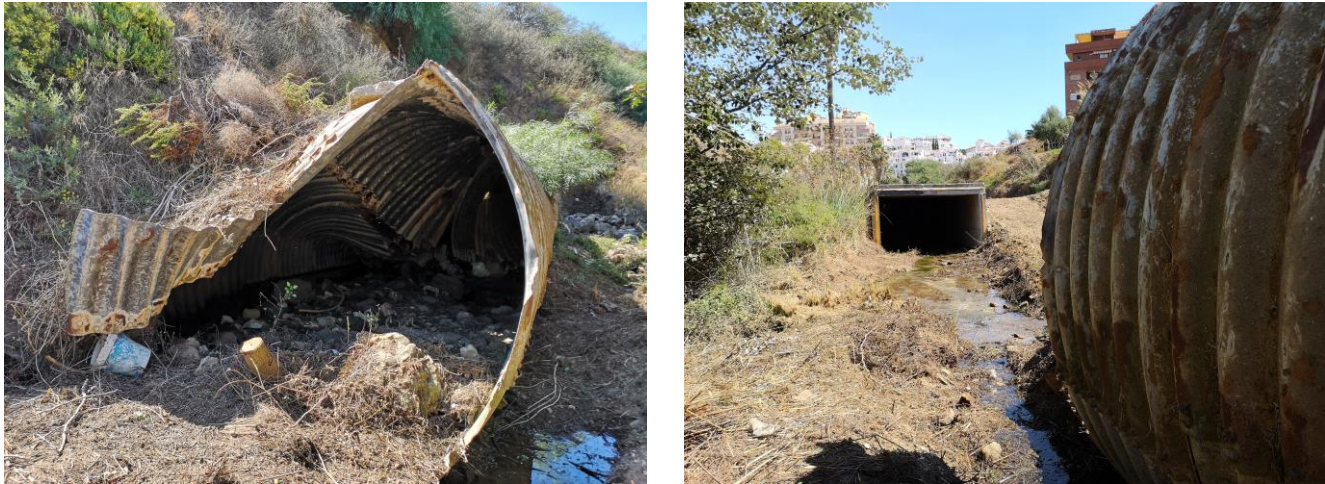
Actual Tubo-arco deteriorado por los desprendimientos de la ladera
